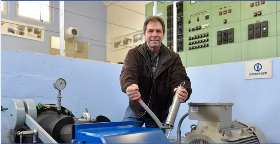
Armin Meier schmiert die Turbine seines Kleinwasser- kraftwerkes, das seit Jahren zuverlässig Strom liefert.
