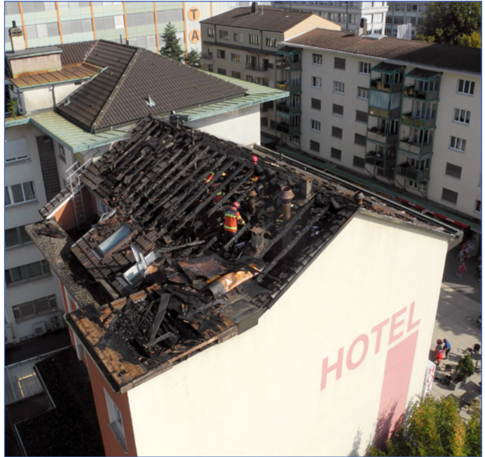
Einblick in den ausgebrannten Dachstock von der Drehleiter aus.
